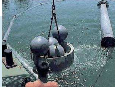
FIGURA 9.39. Montaje Sea Station (Junta de Andalucía).
