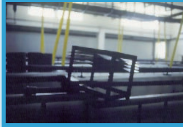
FIGURA 1.87. Estructuras soporte de colectores.
