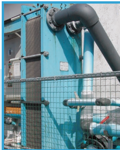
FIGURA 1.73. Intercambiador de calor.
